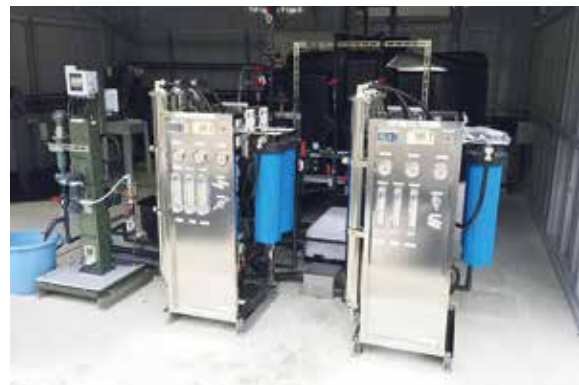
純水を製造するための逆浸透膜装置
